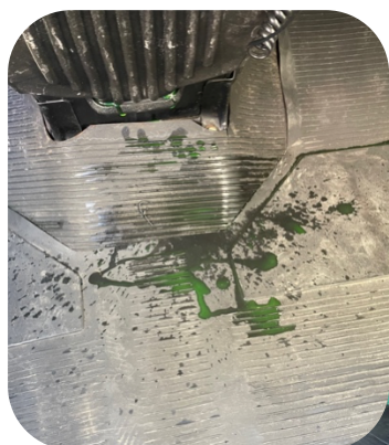
Fuite du radiateur
